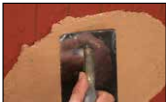
Étape 1 - application directe sur brique plâtrière légèrement humidifiée (pas de sous couche de fond ou d'accroche)
